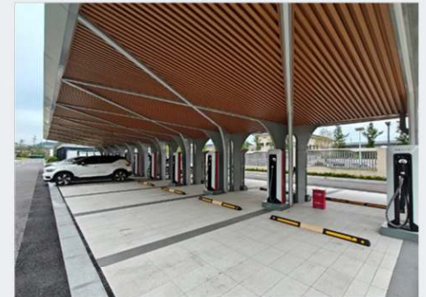
杭州极电储示范站
