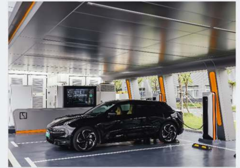
威春电动风光储示范站
